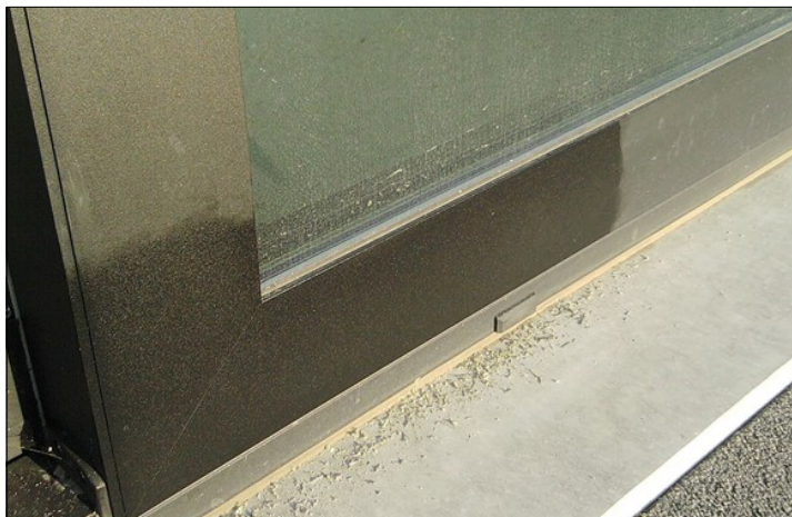
Het verschil tussen een gereinigd en geconserveerd profiel en een niet-gereinigd profiel kan soms opmerkelijk zijn
