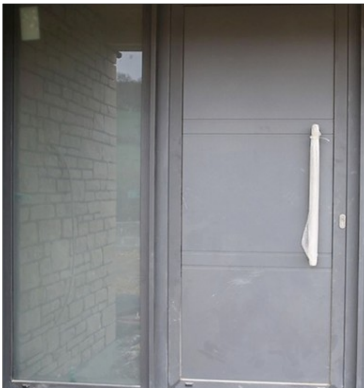
Hoewel dit schrijnwerk perfect proper geplaatst werd, is dit het resultaat na alle pleister- en chapewerken. Een goede werfopvolging door architect en bouwheer zijn cruciaal
