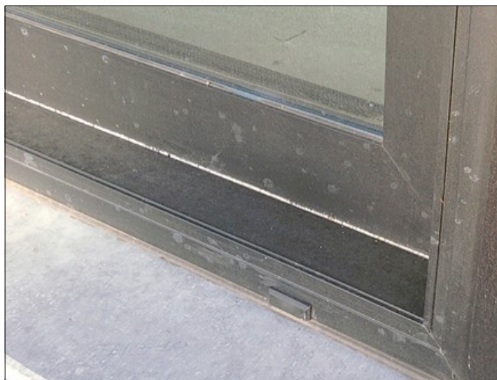
Bij het plaatsen van de dorpel of het leggen van het terras zijn er spatten cementwater op de profielen terechtgekomen, met moeilijk te herstellen schade tot gevolg
